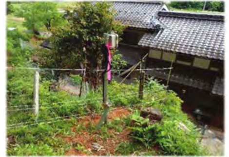
IoT傾斜センサーの設置状況。住民参加でモニタリングを行っています。
