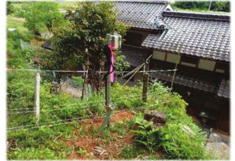
IoT傾斜センサーの設置状況。住民参加でモニタリングを行っています。
