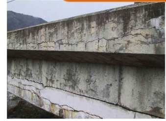
ASRによるコンクリート橋の劣化事例
