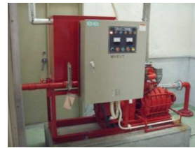
【屋内消火栓ポンプ】
