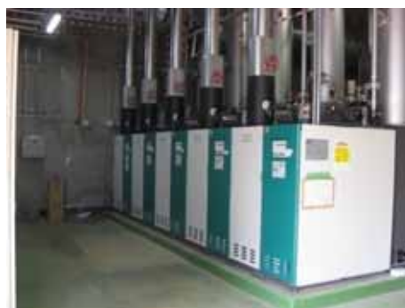
高効率機器の設置状況
