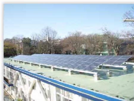
設置の状況 (大学会館)
