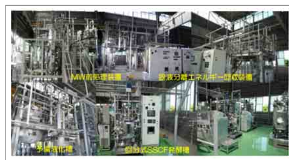
木質系バイオエタノールの一貫製造プラント NEDOプロジェクトチーム工場内に建設
