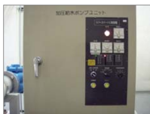
【給水ポンプ】 故障等の場合にも断水が発生することが無いよう、2台のポンプを搭載した給水ユニットとなっています。
