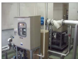
【滅菌装置】 法律に定められた水質を確保するため、滅菌装置による塩素注入を自動制御で行っています。
