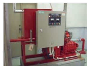
【屋内消火栓ポンプ】 火災初期消火のための屋内消火栓設備に水を供給するためのポンプです。
