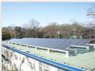
設置の状況 (大学会館)
