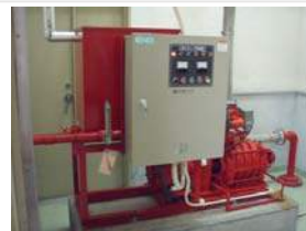
【屋内消火栓ポンプ】
