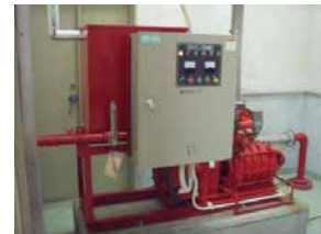
【屋内消火栓ポンプ】
