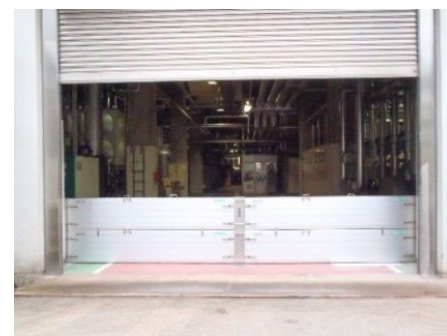
洪水時の浸水を防ぐ止水板
