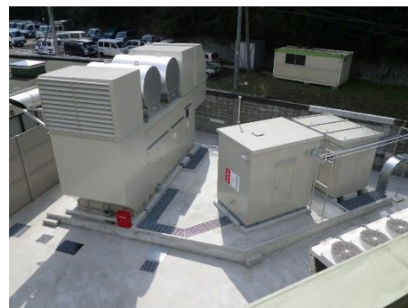
「災害時には通常時の 6 割以上の発電容量のある自家発電機の整備及び 3 日以上燃料を確保」した非常用自家発電設備
