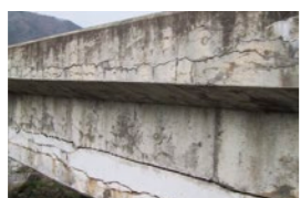
劣化したコンクリート橋(現在は補修済)
